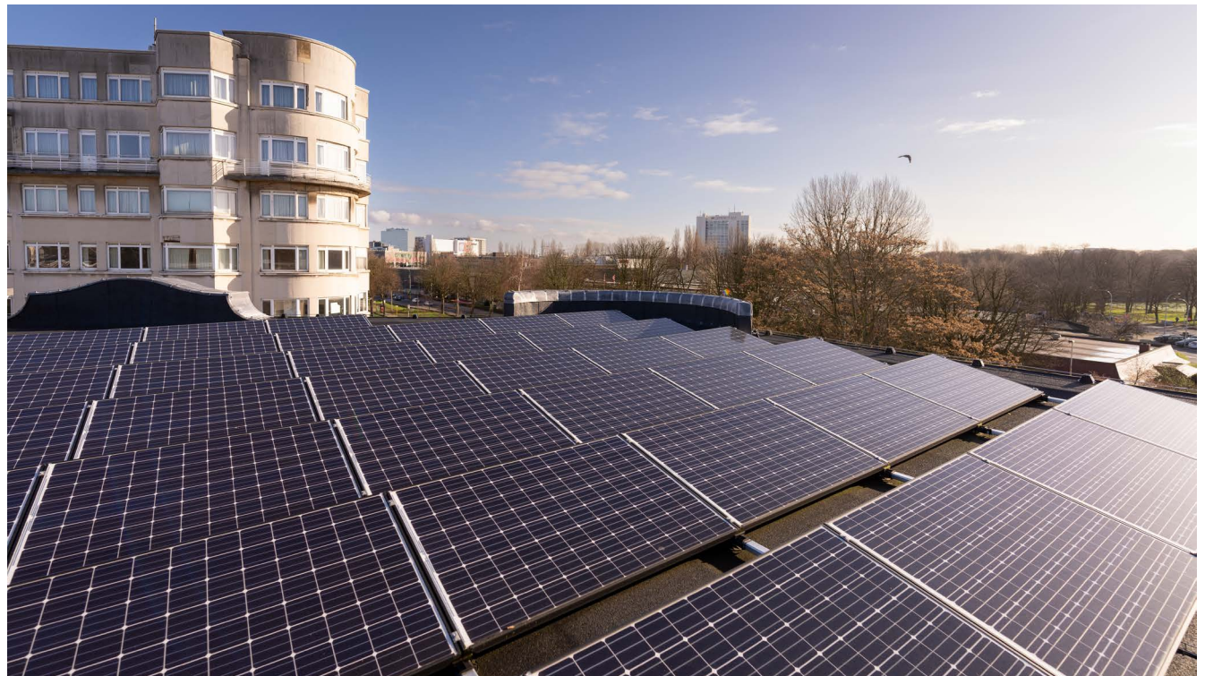
Zonnepanelen op het dak van de hoofdzetel in Antwerpen
